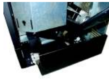
Fig. 55 - Limpieza camara de humos
