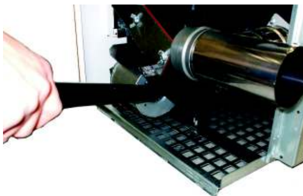
Fig. 61 - Limpieza ventilador ambiente
