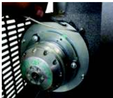
Fig. 45 - Limpieza del aspirador de humos: fase 1
